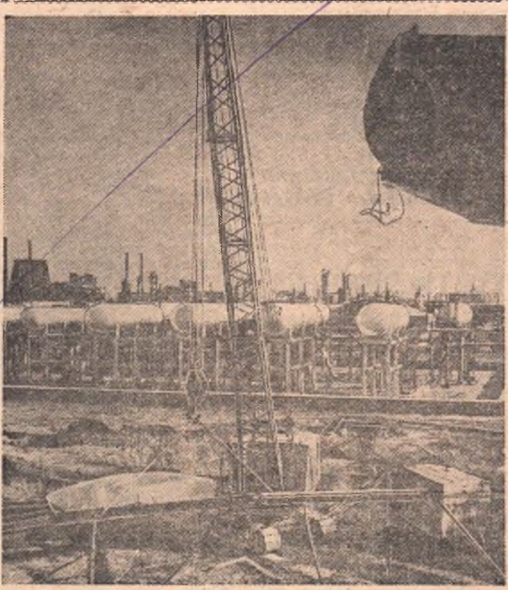
Бригада слесарей-сборщиков тов. Васанского из специализированного управления № 71 ведет сборку газгольдера большой емкости на Омском нефтеперерабатывающем заводе. Готовы трудовой подарок к празднику — 42-й годовщине Великой Октябрьской революции. Фото Э. Савица.
