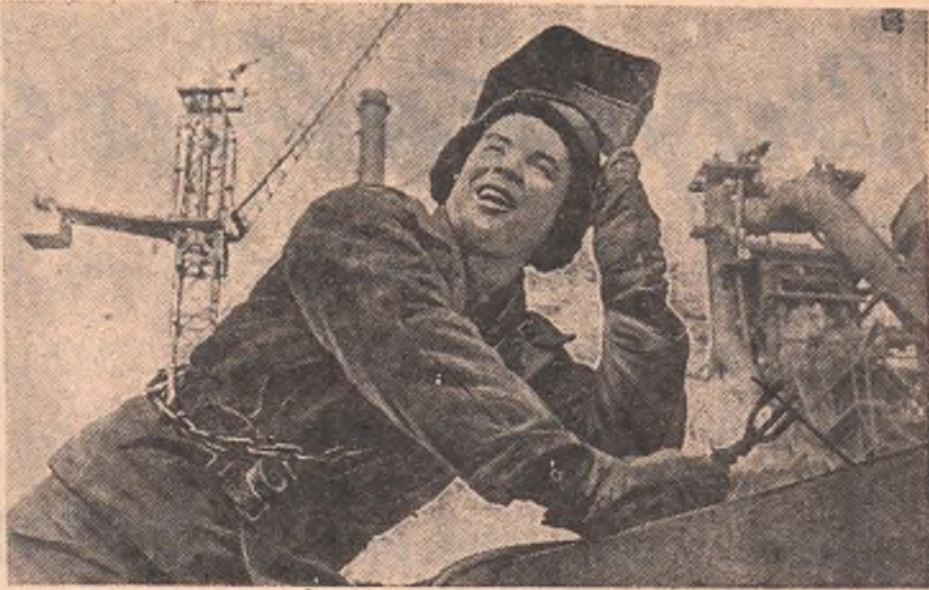
Днепропетровск. На металлургическом заводе имени Петровского сооружается новая мощная доменная печь № 5-бис. Одновременно с бетонированием идет сборка металлоконструкций воздухогревателей печи.
